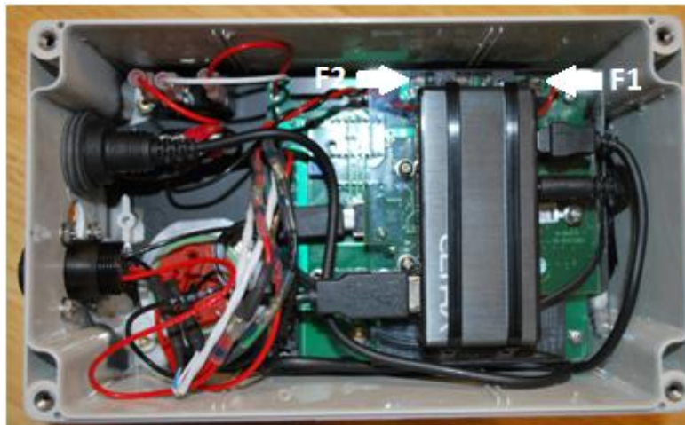
Figure 4 ITI Internal View
